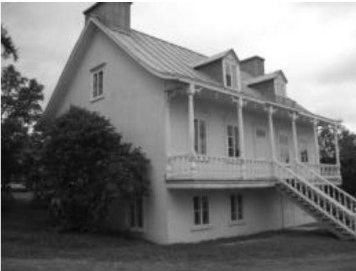
Photo 7 : Garde-fous hors norme
